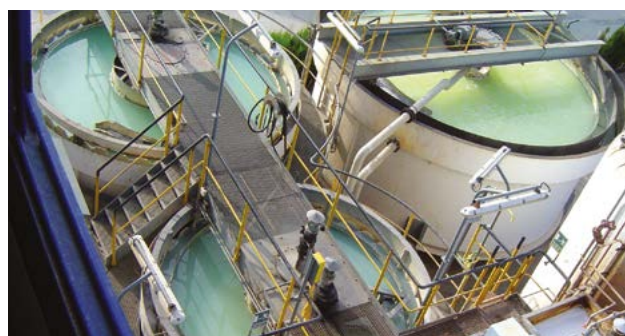
Planta de tratamiento de aguas en Tarragona
